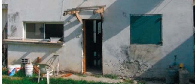
Ściana domu, gdzie uderzyła rakiet.
